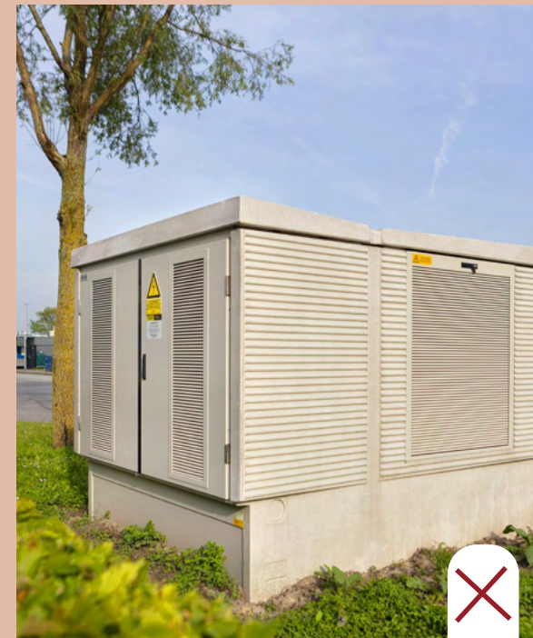
Losstaande trafo of technische ruimte geen onderdeel van het plan.
